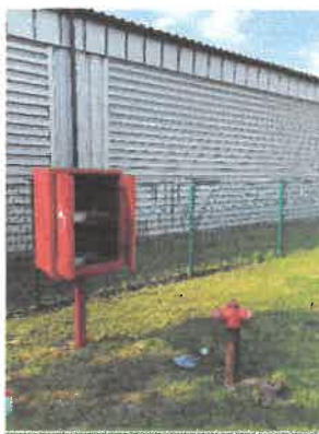
Fot Nr 13 przedstawia miejsce lokalizacji hydrantu zewnętrznego ze skrzynką na osprzęt hydrantowy
