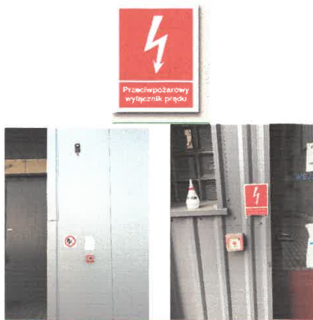
Fot Nr 11-12 przykładowe miejsca lokalizacji wyłączników prądu
